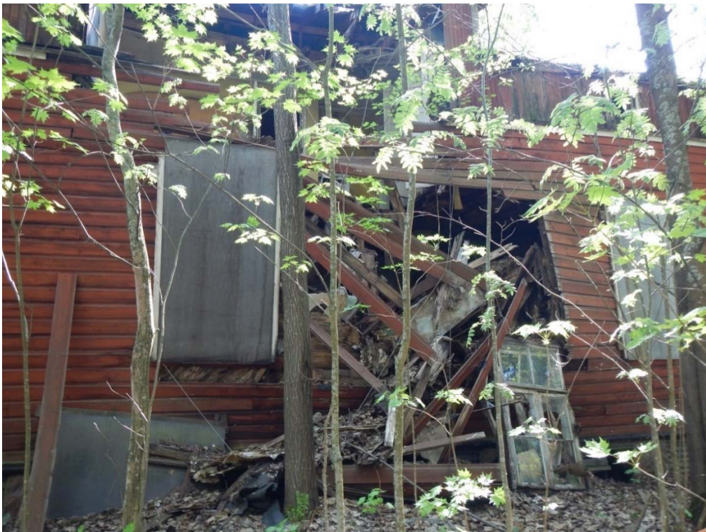
Kuva 22. Tyttölän romahtanut takajulkisivu (16.5.2018)
